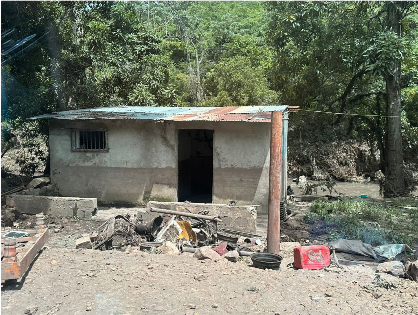
Vivienda afectada en el sector La Fragua
